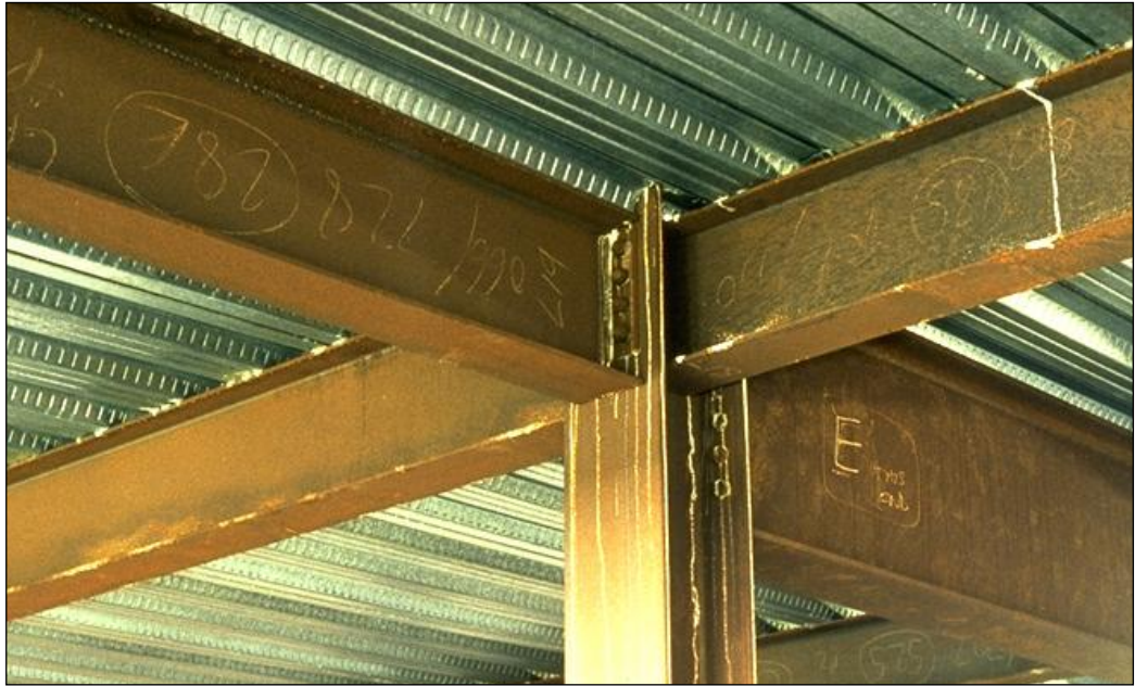
Figura 1.2 Estrutura metálica não protegida
