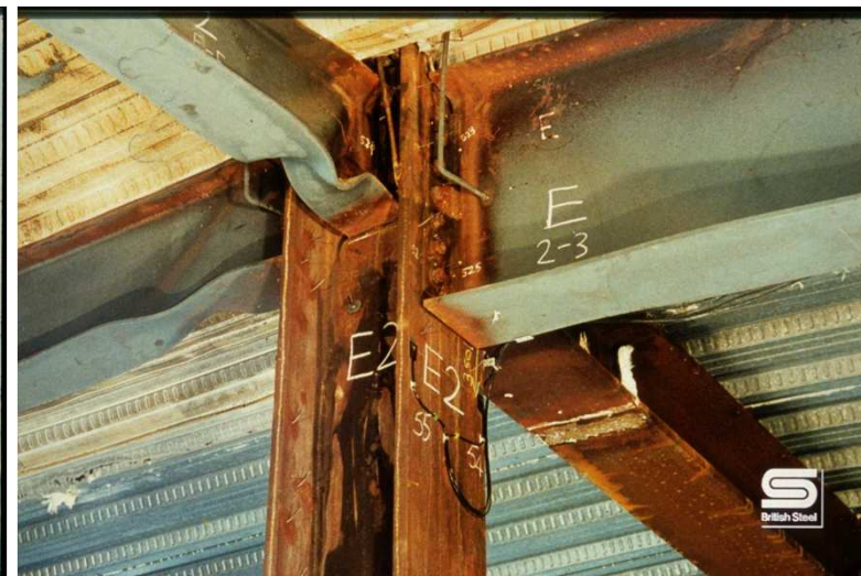
Estado de deformação dos elementos de aço em torno do pilar protegido
